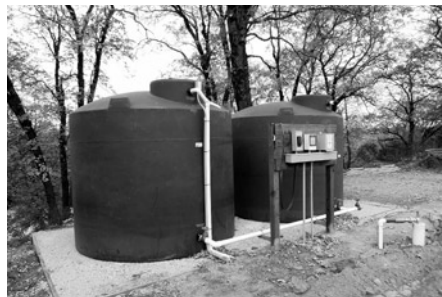
井戸水の貯蔵タンク
